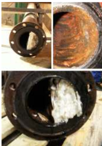
Querschnitte von Wasserleitungen, in denen das Wasser stagnierte (Foto Publitz)
